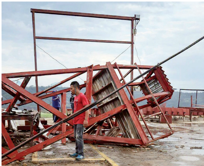
El Centro de Rehabilitación Emmanuel presentó daños en una torre, techos, bardas y estructuras tras el paso del fenómeno.
