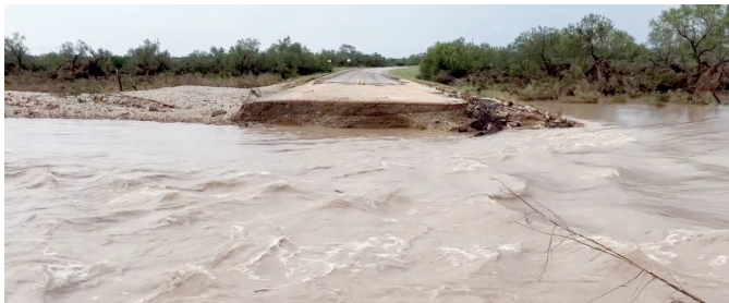
La fuerza de la corriente provocó el colapso del puente sobre el río Nueces, en el camino FM 481 Viejo hacia Uvalde, Texas.
