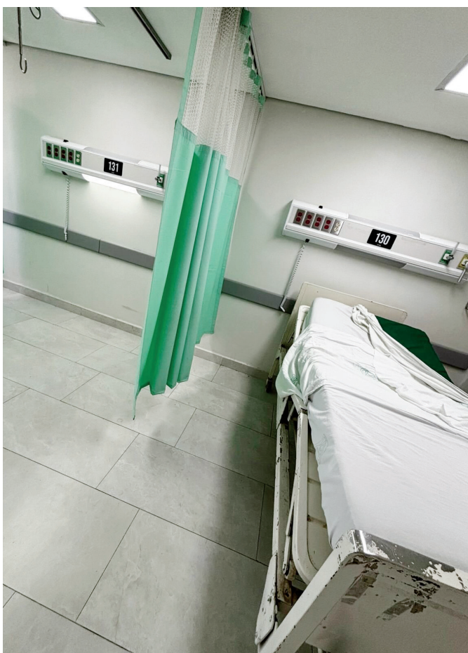
Filtraciones y acumulación de agua en pasillos de la Clínica 7 del IMSS tras las lluvias registradas este viernes en Monclova.
