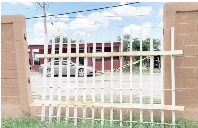
Esta es la reja que colapsó en el lugar.
