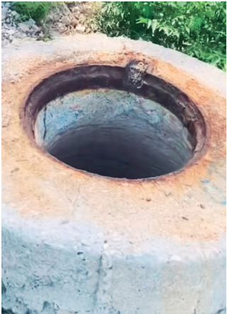
Evidencian robo de tapas de alcantarillado.
