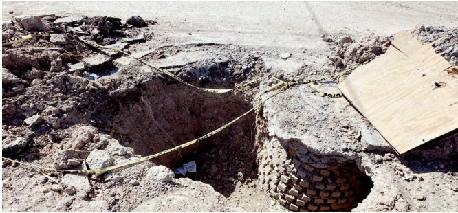
La obra inconclusa, señalan, tiene más de un año sin ser atendida por autoridades municipales.
