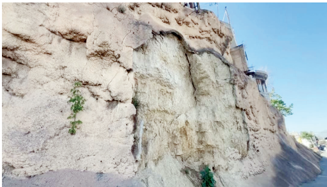
Viviendas de hasta tres niveles se ubican al borde del talud afectado, con cimientos parcialmente expuestos.
