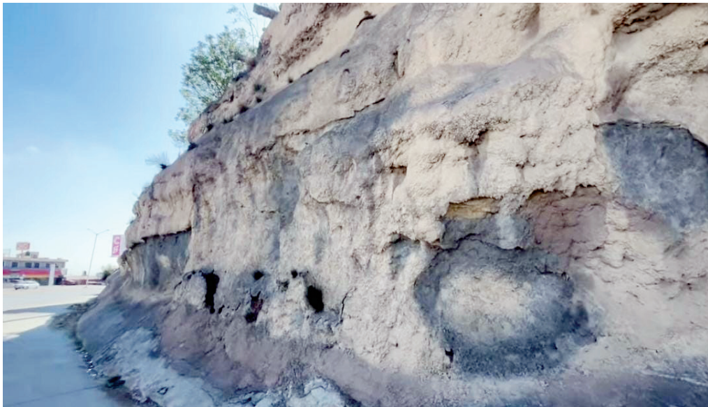
Desprendimientos de tierra y restos de concreto se acumulan en banquetas y carriles de la curva Felipe J. Mery.
